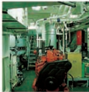
機関室 kikan shitsu engine room
